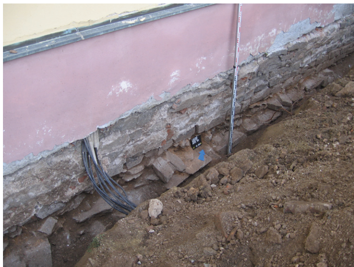
Obr. 16. Loštice, kostel sv. Prokopa. Sonda S4/15, profil P5 na JV straně kostela s románskou zdí 911 (předzáklad). Foto K. Faltýnek.
