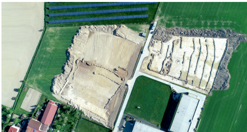
Obr. 14. Otice. Pohled na výzkum v rámci výstavby výrobní haly firmy SEMIX PLUSO, spol. s r.o., z ptačí perspektivy (snímek pořízen pozemním vrtulníkem DJI PHANTOM 4 PRO+). Foto J. Juchelka.
