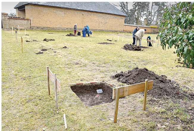
Obr. 82. Příkazy. Hloubení výkopů pro základové patky stodoly, celkový pohled od severu. Foto R. Zatloukal.
