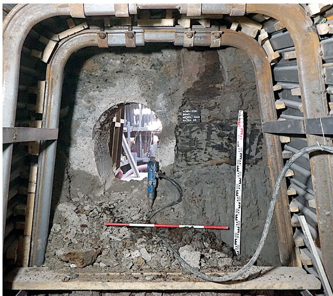
Obr. 30. Brno, Mendlovo náměstí. Středověká úprava jižního břehu Svrateckého náhonu v ražbě kanalizace. Foto Archaia Brno z. ú.
