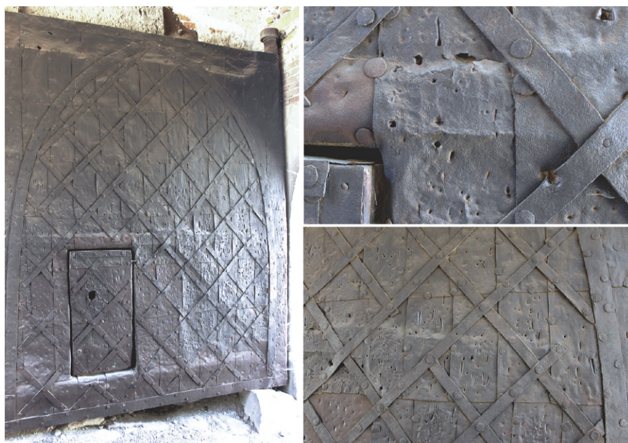
Obr. 72. Vrata pocházející údajně z hradu Zubštejna, dnes instalovaná ve třetí bráně hradu Pernštejna a jednotlivé detaily jejich poškození (foto P. Žákovský).
